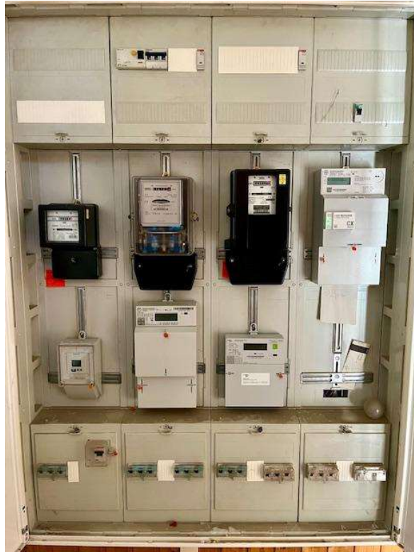
neue Elektroinstallation- Verteilung
